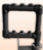
Batería de Contadores
